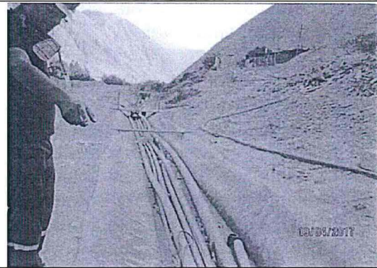
Fotografía N.º 87. Vista de las tuberías de conducción de relaves, donde se observa que se encuentra parcialmente colmatado y/o obstruido.
