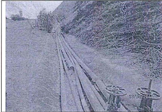
Fotografía N.º 86. Vista de las tuberías de conducción de relaves, donde se observa que se encuentra parcialmente colmatado y/o obstruido.
