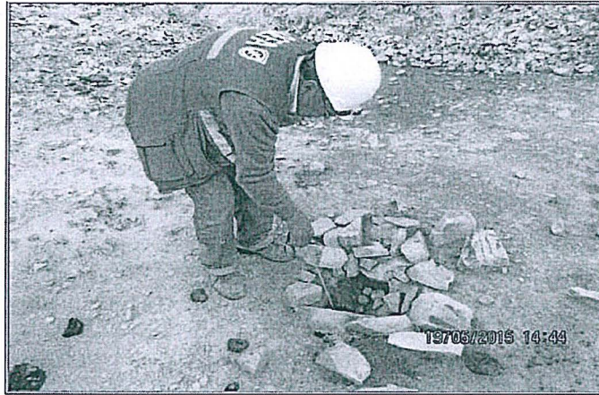
Fotografía N° 39: Plataforma no identificada (6). Pozo no obturado.
