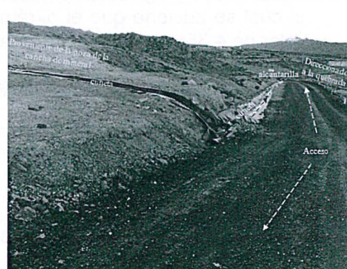
FOTOGRAFÍA N° 15.- El flujo de agua de la poza de la cancha de mineral es evacuado a través de una canaleta revestida con geomembrana hacia la quebrada Pumayo.
