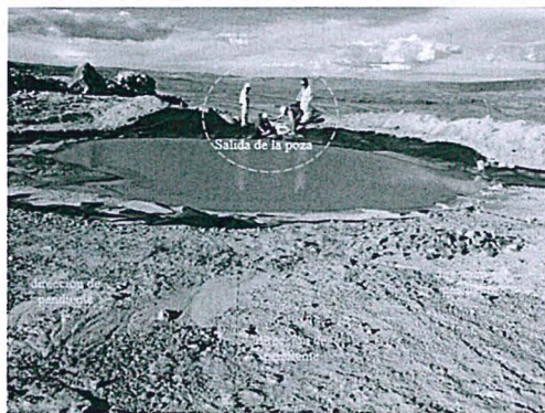
FOTOGRAFÍA N° 14.- Cancha de mineral: sector oeste, se observa una poza revestida con geomembrana, el flujo de agua acumulada es conducida por una canaleta sobre terreno revestida con geomembrana.
