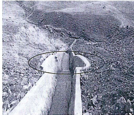
Figura 3. Poza sedimentadora para el control de material en suspensión
