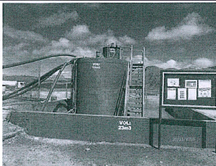
Foto N° 07: En las coordenadas N 8782606 E 0339540, se observa el sistema de contingencias construido y señalización de la capacidad de contingencia de este sistema.
