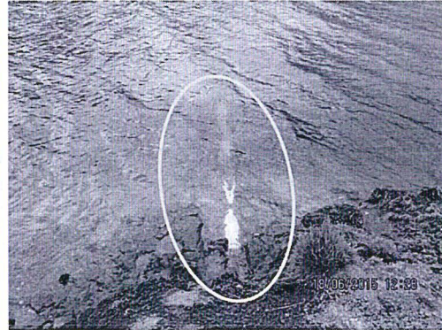
FOTO N° 57: Línea de tubería para la conducción de las aguas de la Planta de tratamiento de aguas residuales domésticas (Tanques Sépticos), que llega hasta la laguna Huacracocha
