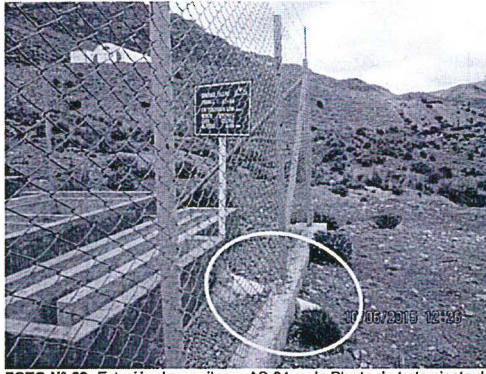
FOTO N° 53: Estación de monitoreo AS-04 en la Planta de tratamiento de aguas residuales domésticas (Tanques Sépticos), y línea de tubería para la conducción de las aguas residuales domésticas tratadas hacia la laguna Huacracocha
