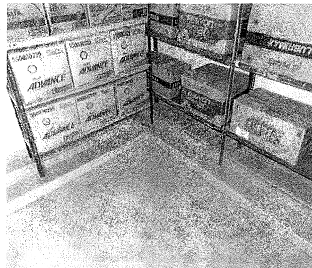
Foto N° 08: Imagen del interior del almacén de productos químicos donde se aprecia la implementación de dos estancias los mismos que se han instalado debajo de los dos estantes de metal que contienen cajas de lubricantes, refrigerantes y cojines, en el piso impermeabilizado
