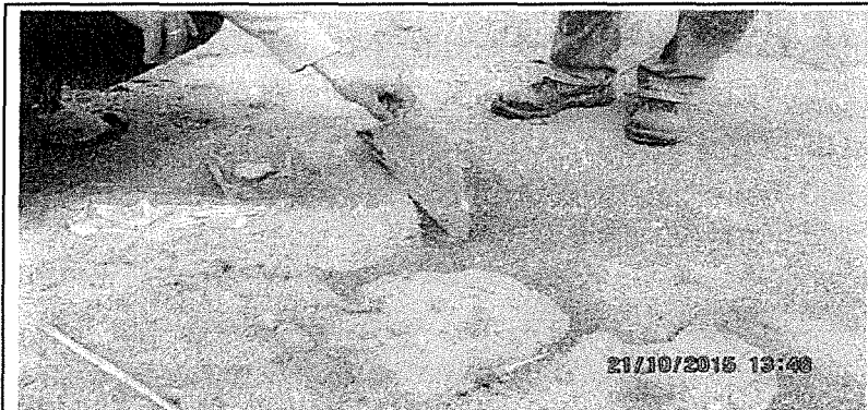
Foto N° 8: La capa superficial observada se encuentra aglomerada superficialmente llegando a formar láminas superficiales sus características son similares a las fibras que se procesa en la planta Trupal Trujillo y se encuentra alrededor de la zona de descarga de sus efluentes industriales a la playa "El Charco".
