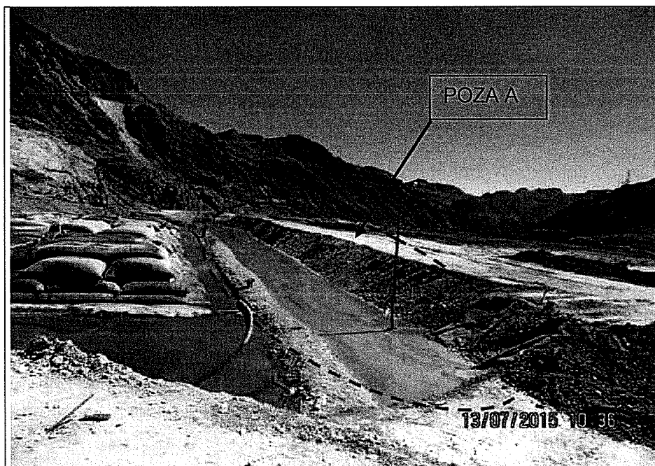
FOTOGRAFÍA N° 4: Se observa una poza que no se encuentra recubierta con geomembrana u otro material impermeable de dimensiones aproximadas 100x3 metros. En el interior de dicha poza se observa lodo el cual proviene de la poza que se encuentra a la izquierda y que contiene a los geotubos (contenedores hechos de geotextil).
