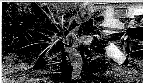
FOTOGRAFÍA N°1: Hallazgo 1: En la zona de planta de tratamiento de agua residual doméstica compacta Paraiso (coordenadas UTM 84 N 9146677 y E 209048), se procedió a retirar el material proveniente del lodo del lecho de secado de la planta de tratamiento convencional anaeróbica de agua residual doméstica Paraiso.
