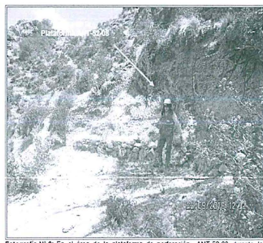
Fotografía N° 2: En el área de la plataforma de perforación ANT-52-08, durante las acciones de supervisión no se encontraba perfilada, con talud de corte de 3 m alto. Asimismo al pie se observó un muro de contención de rocas.
