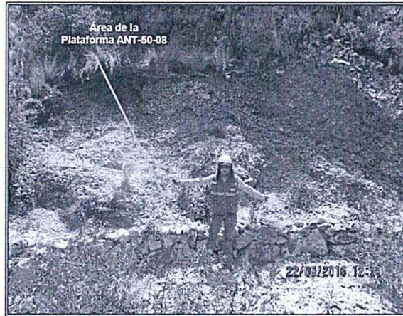
Fotografía N° 3: En el área de la plataforma de perforación ANT-50-08, durante las acciones de supervisión no se encontraba perfilada, con talud de corte de 3 m alto. Asimismo al pie se observó un muro de contención de rocas.
