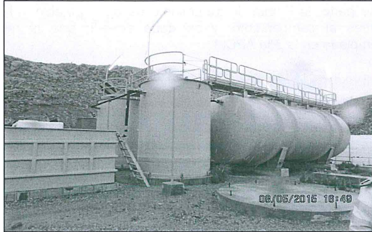
Fotografía N° 79: Planta de Tratamiento de Aguas Residuales Domésticas – PTARD. Componente activo; aún no se han ejecutado actividades de cierre.
