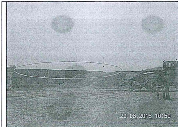
Foto N° 6: Vista del perímetro cercano a la cancha de agregados, igualmente no se observa el acondicionamiento de malla rashel.
