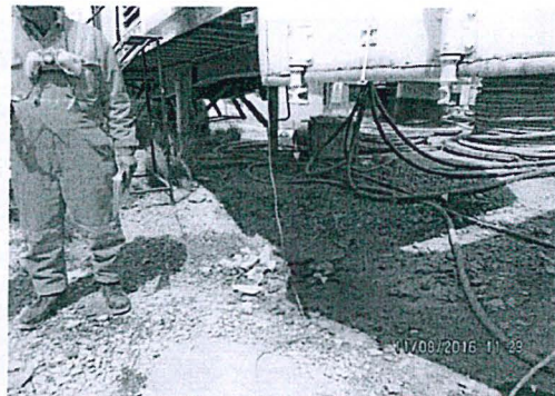
Fotografía N° 23.- Se observó que la base o superficie donde se encontraban los dos contenedores que contenían los dos grupos electrógenos de 10 000 kW, presentaba restos de derrame del combustible utilizado por los generadores, estos contenedores se ubicaban en el interior del área del taller de mantenimiento. Coordenadas UTM datum WGS 84: 389 464 E, 8 701 853 N y 4 449 m s n m
