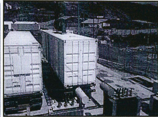
Foto N°6: Ubicación de los Grupos Electrógenos y Transformadores - marzo 2018.
