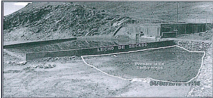
Fotografía N° 1: Hallazgo N° 1: Se observó que la poza de sedimentación ubicada en coordenadas UTM (WGS 84) N: 8844483, E: 360370; presenta filtraciones lo cual genera el empozamiento de agua en el lecho de secado y el arrastre de sedimentos sobre el suelo fuera del área de la poza de sedimentación.
