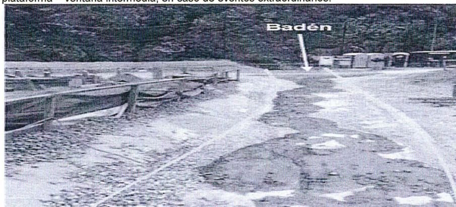
Fotografía 3: Badén de plataforma de ventana intermedia para canalización de aguas de Qda. Altaranito hacia el río Asana ante eventos extraordinarios.
