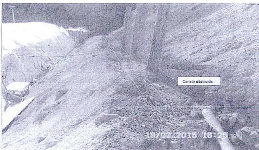
Fotografía N° 7. HALLAZGO N° 2; La cuneta superior del área de plataforma de la ventana del túnel de derivación del río Asana; donde se ubican equipos, oficinas y almacén; se encuentra obstruida, desde las coordenadas N 8108358 E 0324673; hasta las coordenadas N 8108394, E0324667, en el sistema WGS 84.
