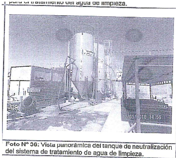
Supervisión del 4 al 11 de mayo de 2018: Foto del tanque de neutralización del sistema de tratamiento de efluentes
