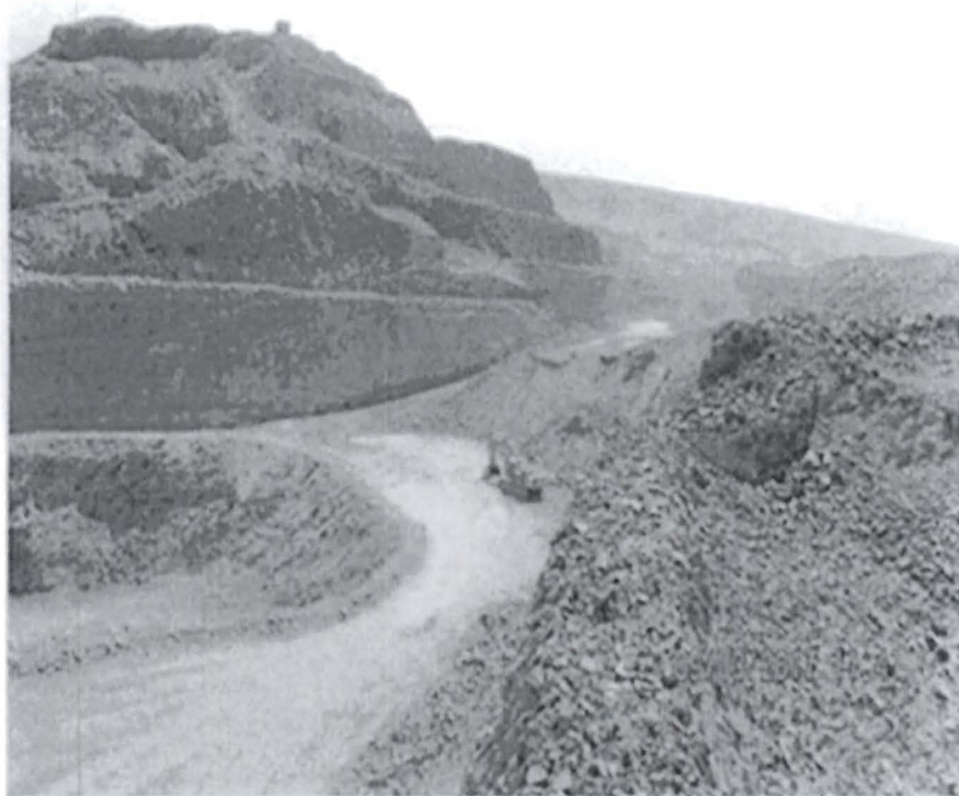
Fotografía N° 22: Vista fotográfica del extremo de la ampliación del tajo, que se conecta mediante un acceso con el tajo de operaciones.
