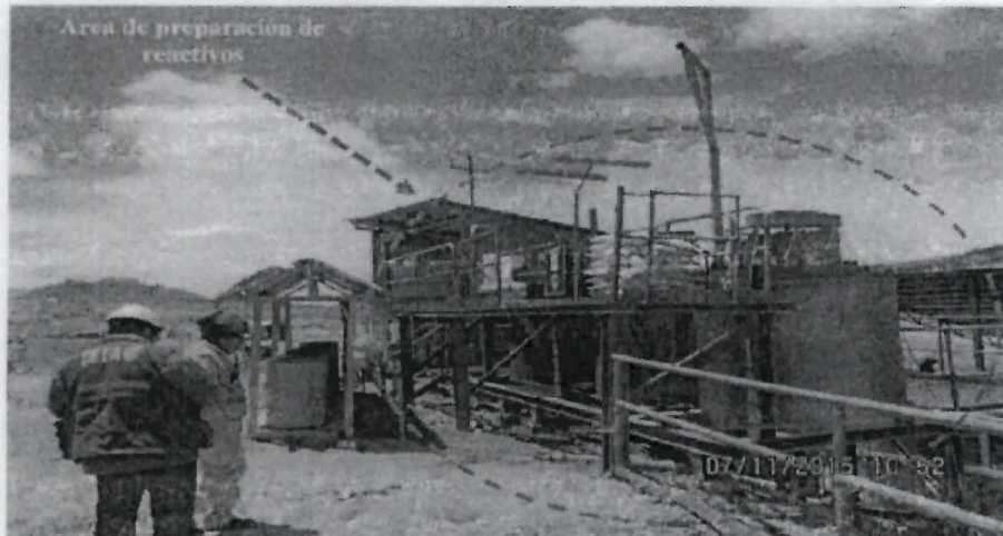
FOTO N° 132: Hallazgo N° 1, Supervisión Regular Noviembre 2015. En la Planta Concentradora Caudalosa Grande se observó que los tanques de preparación de reactivos no cuentan con un sistema de contingencia para derrames situado en las coordenadas UTM WGS84 N 8 541131, E 476381.
