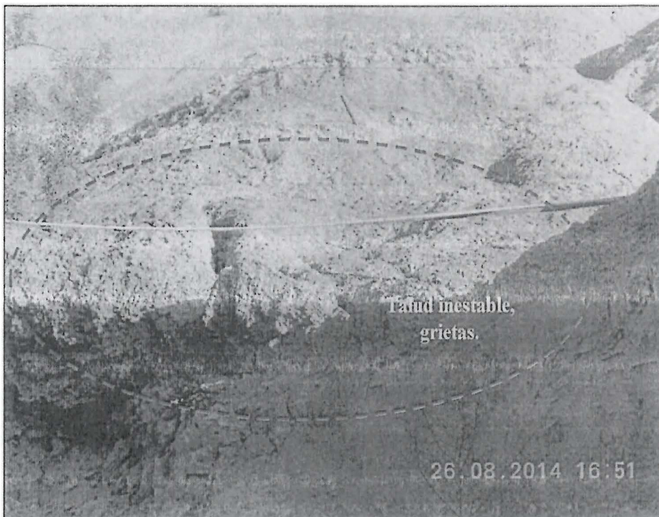
FOTO N° 55 Hallazgo N°2, Se observa que la relavera de cianuración N°3, no tiene muro de contención, presenta erosión y desprendimiento de relave. Coordenadas (Datum GWS84) N8252997, E657185.
