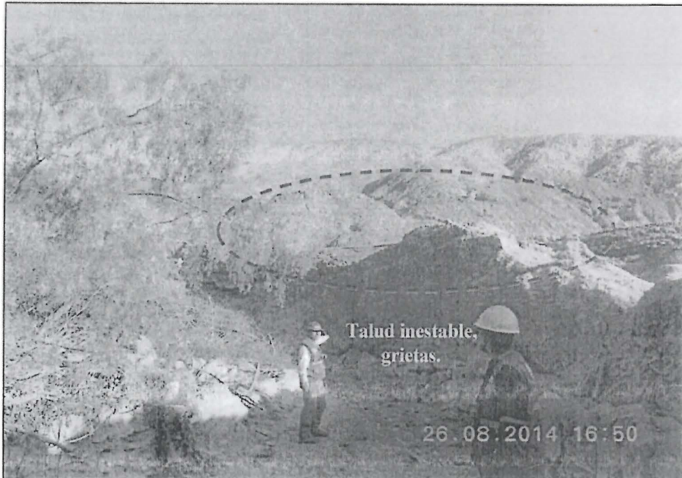
FOTO N° 53 Hallazgo N°2, Entre la relavera de cianuración N°1 y N°2 se observa la inestabilidad de los taludes, no presenta canal de coronación, resquebrajamiento, grietas. Coordenadas (Datum GWS84) N8252939, E657280.
