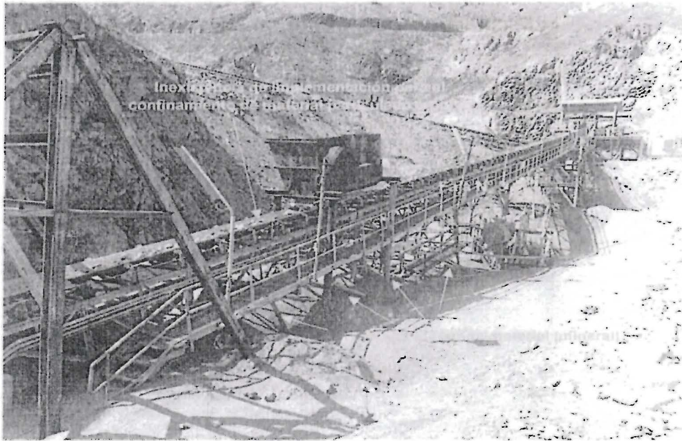
Fotografía N° 3: Por debajo de la infraestructura de la faja transportadora N° 3 se advierte la acumulación de mineral, la misma que se encontraba en contacto directo con la superficie del suelo
