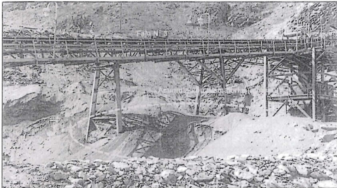
Fotografía N° 2: Por debajo de la infraestructura de la faja transportadora N° 3 se advierte la acumulación de mineral, la misma que se encontraba en contacto directo con la superficie del suelo.
