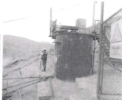
Fotografía N° 030: HALLAZGO N° 01, Tanque metálico de preparación de solución de cianuro de sodio, capacidad 10 m3, se encuentra apoyado sobre una base de concreto.
