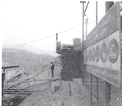
Fotografía N° 031: HALLAZGO N° 01, Tal como se aprecia en la imagen, el tanque de preparación carece de un sistema o medio que le permita contener y recuperar los posibles derrames de solución de cianuro de sodio.
