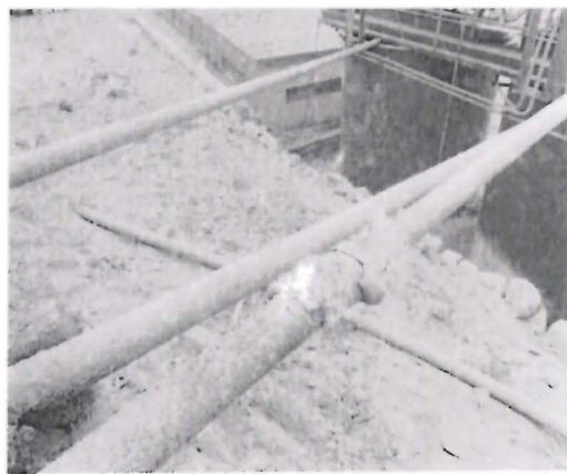
Fotografía N° 032: HALLAZGO N° 01, Línea de conducción de solución, interconecta el tanque de preparación y tanques de almacenamiento de solución.
