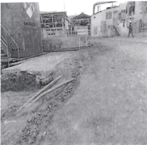
Fotografía N° 052: HALLAZGO N° 02. Nótese, el manejo de aguas sobre el suelo debido a la falta de sistemas de drenaje.
