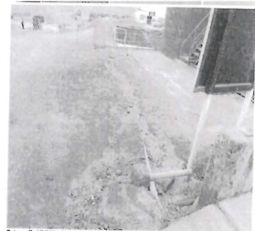
Fotografía N° 053: HALLAZGO N° 02. Este tramo, corresponde a la zona de los tanques de cianuración, nótese que el agua corre sobre el suelo debido a la falta de un sistema de coleccion y conducción.
