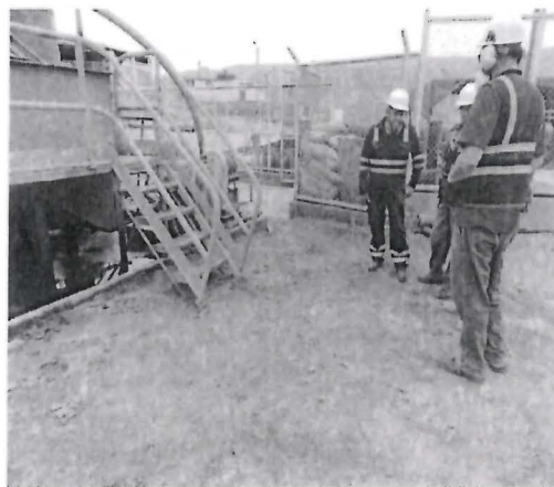
Fotografía N° 058: HALLAZGO N° 03, En la imagen se observa que la superficie exterior al sistema de bombeo, está comprendida por suelo.
