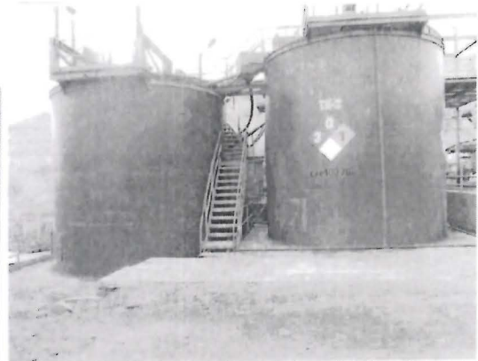
Fotografía N° 051: HALLAZGO N° 02. Tanques de cianuración, nótese en los extremos la plataforma de concreto la falta de un sistema que permita colectr conducir las aguas de lavado de pisos y equipamiento.
