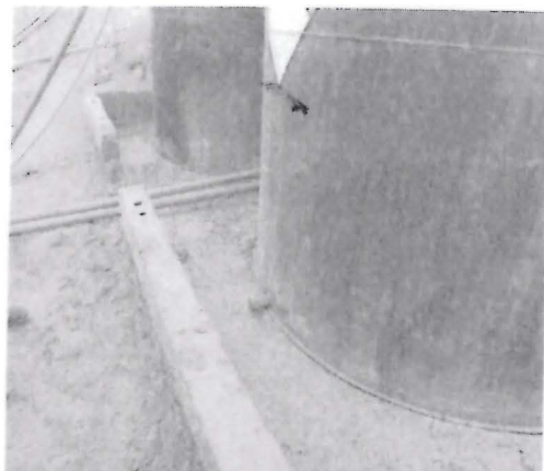
Fotografía N° 038: HALLAZGO N° 01, El sistema de contención se encuentra abierto y no cuenta con la capacidad del 110% del volumen del tanque de mayor capacidad.
