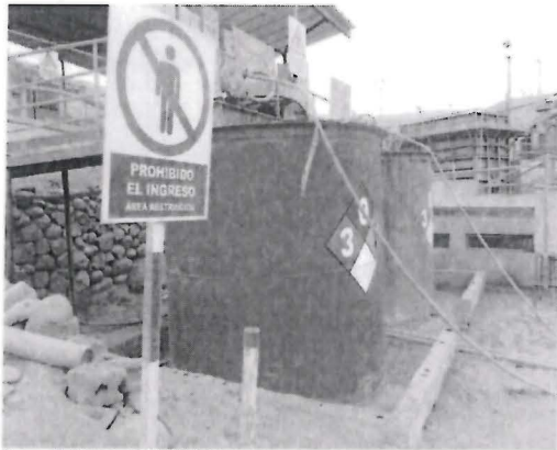
Fotografía N° 036: HALLAZGO N° 01, Tanque de almacenamiento de Soda Caustica y cianuro de sodio; la estanca se encuentra abierta y no tiene la capacidad del 110% del tanque de mayor capacidad.
