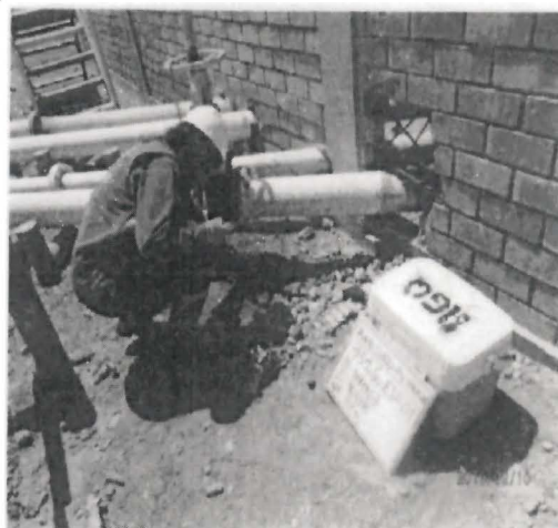
Registro Fotográfico N° 22; Punto de muestreo de suelo entre la zona estancia de los tanques de almacenamiento y la pared lateral de la Planta de Ventas Talara con coordenadas UTM WGS84 (0469398E 9491967N)
