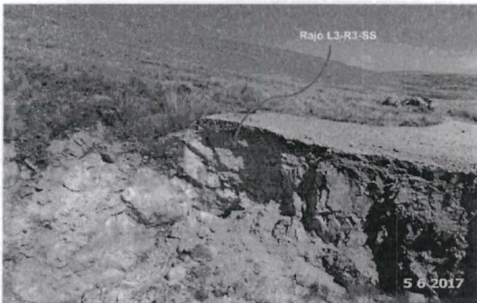
Fotografía N° 27: Vista del segundo tramo del rajo L3-R3-SS, ubicada en coordenadas UTM (WGS 84), E: 227877 N: 8914650, se observa material expuesto al ambiente.
