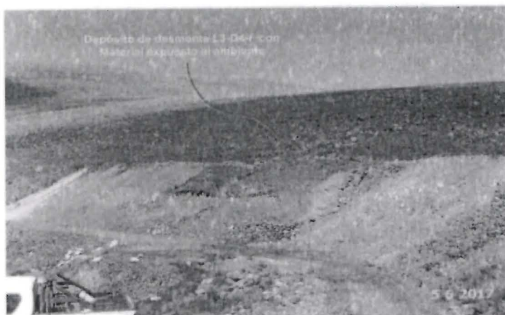
Fotografía N° 14: Vista del depósito de desmorte L3-D4-F ubicada en coordenadas UTM (WGS 84), E: 227803 N: 8915161, se observa su talud con material de desmorte expuesto al ambiente.
