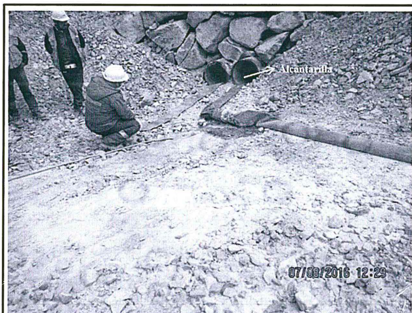
FOTOGRAFÍA N° 13.- Alcantarilla a la cual debió llegar a conectar la manga de polietileno que transporta el agua del Tajo Constanca – Fase III.
