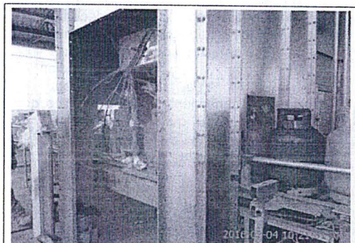
Fotografía N°08 Se observa el área de pintado de balones, el cual esta provista de una cabina y motor extractor de gases. Coordenadas 19 L 8281516 N 0380835 E
