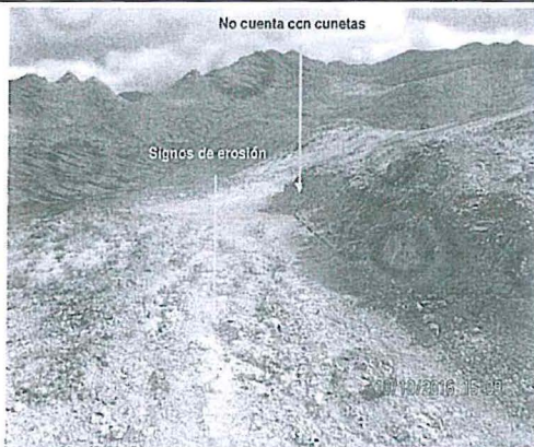
Fotografía N° 32: Nótese, la vía de acceso principal que conduce a las plataformas de perforación verificadas en campo, no cuenta con infraestructura hidráulica (cunetas) para la derivación de aguas de escorrentía en un tramo de 1000 metros aproximadamente de trocha carrozable.
