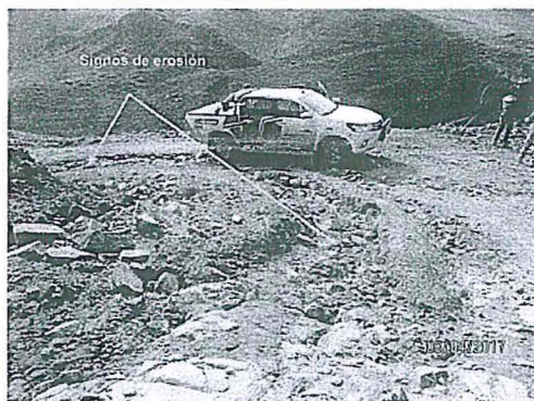
Fotografía N° 20: Vía de acceso principal que presenta un área carcavada producto de la erosión, al no contar con infraestructura hidráulica (cunetas).
