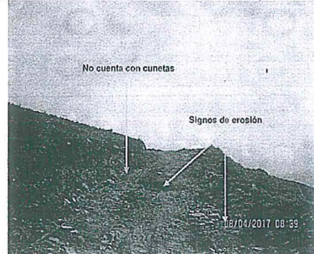
Fotografía N° 21: Otra vista de la vía de acceso principal que se encuentra carcavada producto de la erosión, al no contar con infraestructura hidráulica (cunetas)
