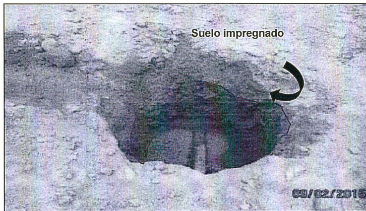
Fotografía N° 24. Pozo PU – 6716 Órganos Patria, se observa suelo antiguo impactado en un hueco; así como una línea de 2 pulgadas en abandono. Coordenada UTM: 9536980N; 486133E.
