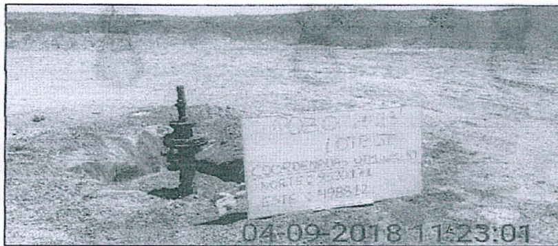
Fotografía N° 2.- Obsérvese el Pozo H-23 con Geomembrana en la cantina, protegiéndolo con sistema de contención.
