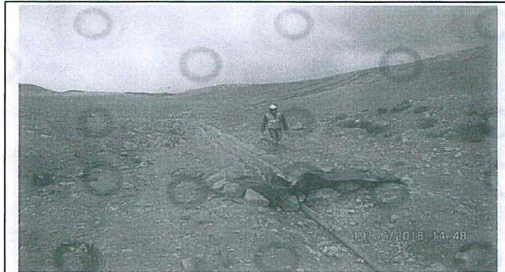
Fotografía N°30. Se observa al personal de OEFA, en la parte final del canal en geomembrana, el cual tiene por fin conducir las aguas de la plataforma observada si es que se generara la misma, asimismo al final del canal se tiene empalmada una tubería de HDPE de 4" con el fin de conducir el flujo de agua hacia el sistema de tratamiento dl Botadero N° 3.
