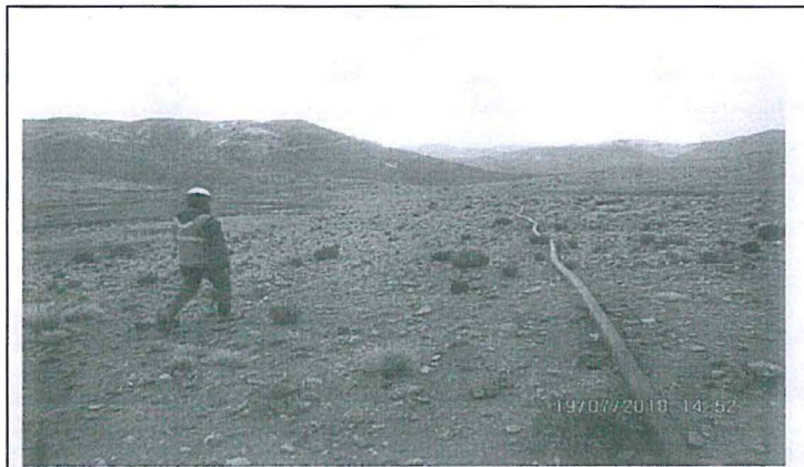
Fotografía N°32. Se observa al personal de OEFA, realizando la revisión de la continuidad de la tubería de conducción implementada, entre la zona del Tajo Valle y Botadero 3, con el fin de evitar la acumulación de agua.
