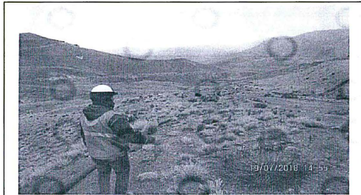
Fotografía N°33. Se observa al personal de OEFA, realizando la revisión de la continuidad de la tubería de conducción implementada, la misma que tiene como fin el sistema de tratamiento wetland del Botadero N° 3.
