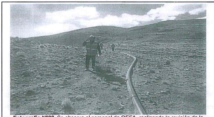
Fotografía N°22. Se observa al personal de OEFA, realizando la revisión de la continuidad de la tubería de conducción implementada, entre la zona del Tajo Valle y Botadero 3, con el fin de evitar la acumulación de agua.
