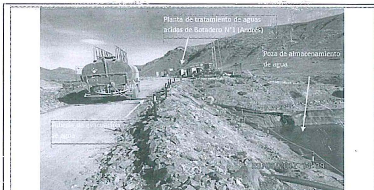
Fotografía N° 16. Se observa la cisterna de agua evacuando el agua succionada la misma que desfoga hacia la poza de almacenamiento de la planta de tratamiento del botadero 1 – Zona Andrés
