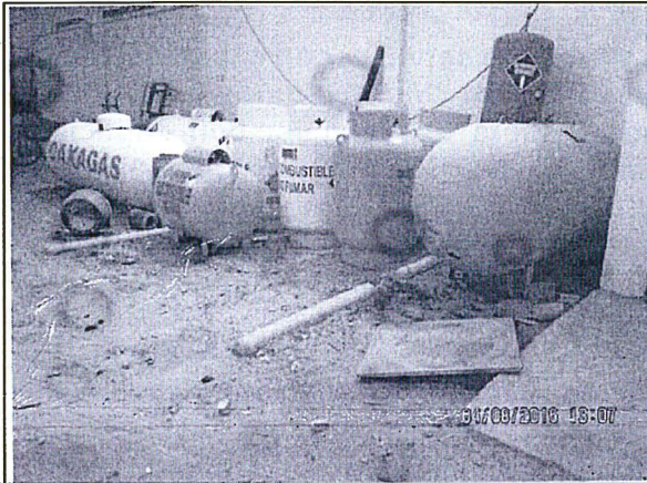
Fotografía N°18 En la vista fotográfica se verificó que al lado del almacén de sustancias químicas se verificó 07 tanques de GLP de 120 gls, 03 tanques de GLP de 500 gls. al parecer vacíos sobre suelo natural ocupando un área de 2 m x 4m aproximadamente. Coordenadas UTM WGS 84, zona 17M, 9205489 N, 0777031 E.
