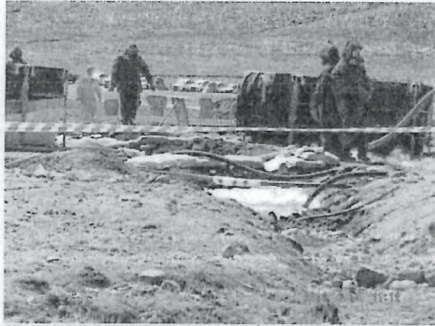
FOTO N° 04: N8508123 E482395/ PUNTO DE FUGA EN LA LINEA DEL DUCTO LGN
