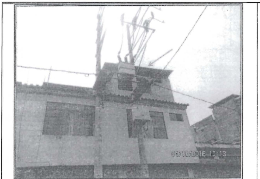
Fotografía N° 2. Vista de la Subestación de Distribución E435308 de 40 kVA.
