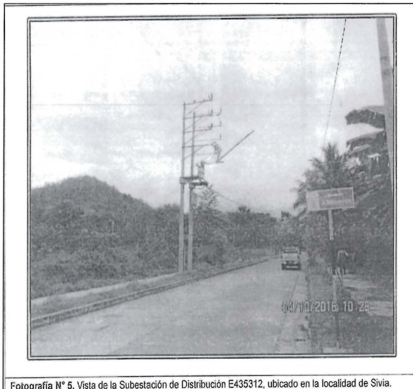
Fotografía N° 5. Vista de la Subestación de Distribución E435312, ubicado en la localidad de Sivia.
