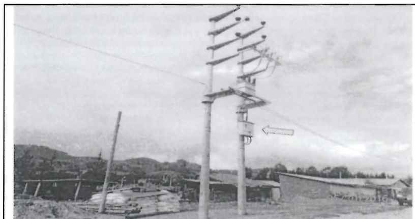
Fotografía N° 1. Vista de la Subestación de Distribución E435304, ubicada en la localidad de Coraspampa, distrito de Los Morochucos y provincia de Cangallo.
