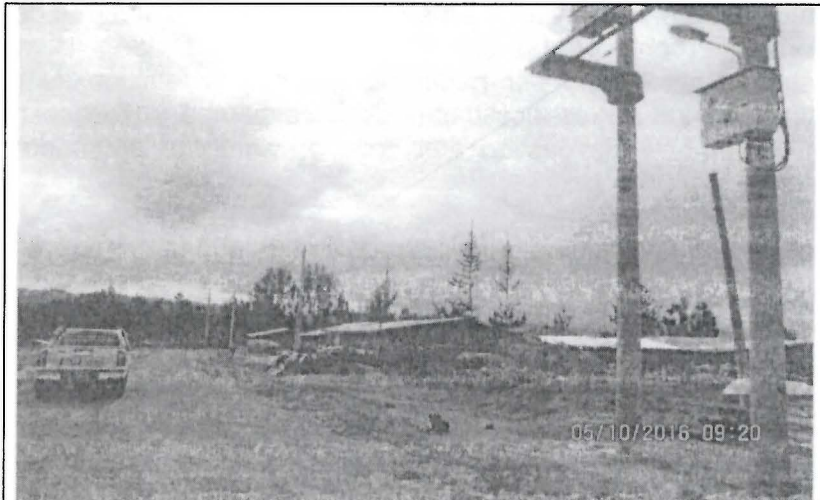
Fotografía N° 2. Vista de los alrededores de la Subestación de Distribución E435304: postes de concreto, tendido de conductores y viviendas que vienen siendo abastecidas de energía.
