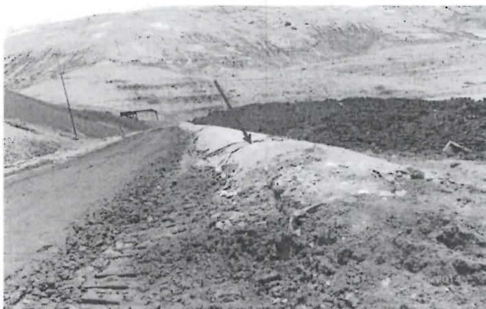
FOTO N° 172: Hallazgo N° 10 Supervisión 2014. En el muro de contención del depósito de ferritas de zinc aledaño a la vía de ingreso, se observa la geomembrana en malas condiciones (rotas) y en ciertas partes no existe.
