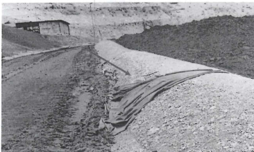
FOTO N° 173: Hallazgo N° 10 Supervisión 2014. Otra vista del muro de contención del depósito de ferritas de zinc alledaño a la vía de ingreso, donde se observa la geomembrana en malas condiciones (rotas) y en ciertas partes no existe.
