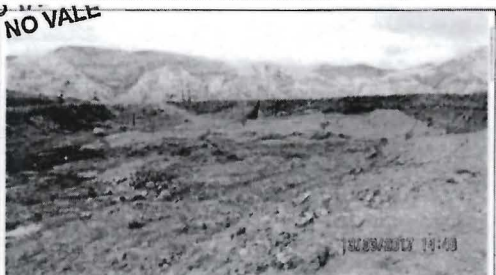
Fotografía N° INC-11. Otra vista del área N° 4, donde se encuentra el depósito de material excedente (tierra) y material de construcción sobre suelos removidos de cobertura vegetal; a su vez se observó formación de charcos de agua cercanos a dichos depósitos.
