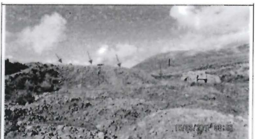
Fotografía N° INC-10. Vista cercana del área N° 4, donde se depositan material excedente (tierra), parte de ella esta conformada sobre un talud y otra parte se encuentra dispersa sobre suelos removidos y sin cobertura vegetal.
