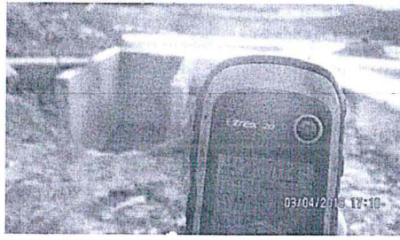
Fotografía N° 11- Vista del cajón colector de concreto N° 2 para manejo de aguas provenientes del patio de mantenimiento de equipos, en las coordenadas UTM WGS84 N 8 810 211H y 359 775E.
