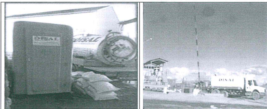
Foto N° 9 y 10: Vista de la limpieza de baños químicos instalados en el tajo y su posterior descarga a la planta Aqua Cear de tratamiento de agua residual domésticas.
