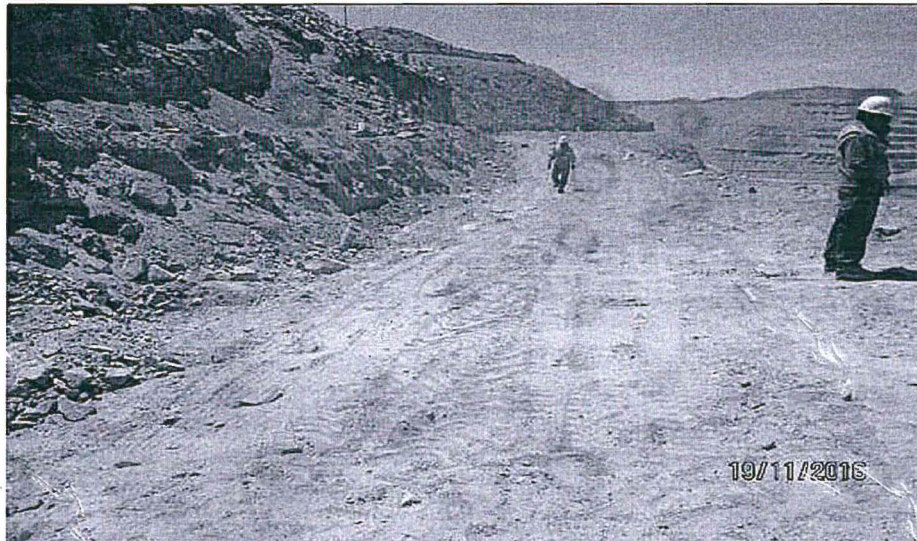
Fotografía N° 125. Hallazgo N° 1: Vista de la zona en el cual se ubica el canal de derivación de agua de escorrentía en el cerro Buitreras, se observa que esta nivelado tipo vía, no observándose canal alguno.
