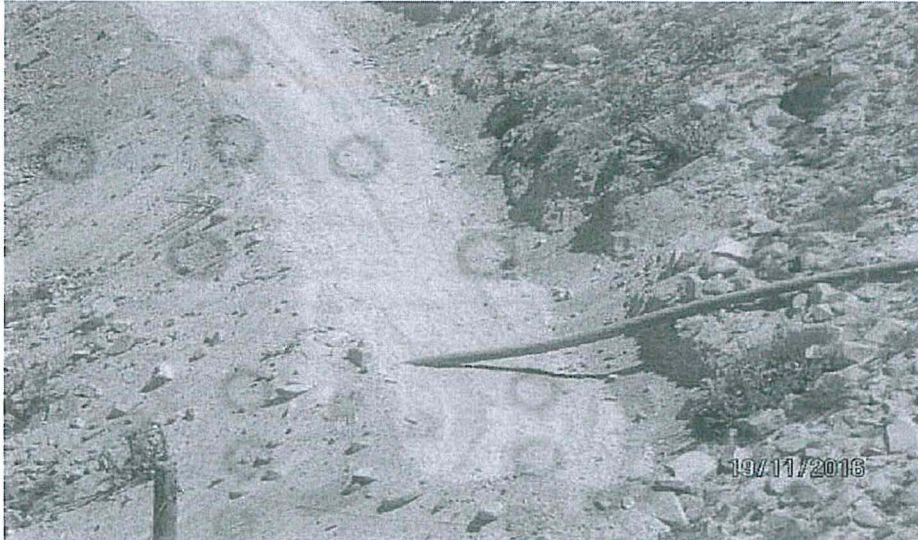
Fotografía N° 130. Hallazgo N° 1: En la zona del cerro Toquepala no se observa que exista un sistema de conducción del agua de escorrentía, en la foto se observa que no tiene continuidad la zona que podría ser el canal.
