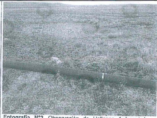
Fotografía N°2 Observación de Hallazgo 1 levantado, se observa tapón de silicona, polímero elástico y cinta metálica cerrando el agujero, se observa suelo sin huellas en el terreno
