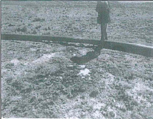
Fotografía N° 1: Hallazgo 1: Se observaron perforaciones en algunos sectores, así como huellas en el terreno, producto de las fugas.
