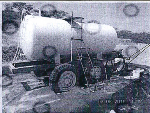
FOTO N° 4 Personal del OEFA realizó la toma de muestra de suelo de código 167,6,ESP-1. Se observa que geomembranas no cubren área donde se ubican llantas de estructura metálica que soporta al tanque horizontal. Coordenadas UTM - WGS 84: 0540623 E, 9591560 N
