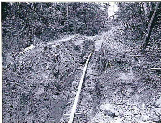
Se ha excavado una zanja de 1.50 m x 14.0 m x 1.40 m para reparación de la línea de conducción. A la fecha de la presente supervisión de campo, aún no se realiza el tabado la zanja.
