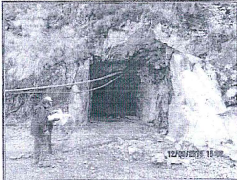
Fotografía N° 87: Hallazgo 10a: La entrada a la bocamina B-SR-09, ubicada en la unidad minera Santa Rosa, en las coordenadas UTM WGS 84 8701022N y 501250E no está bloqueada
