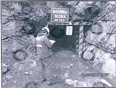
Fotografía N° 28: Hallazgo 4a: En la bocamina Bedoya N°. 4215 de código B-SI-02, se constató que el acceso no está bloqueado, existe el riesgo de ingreso de personas y/o animales al interior de la galería
