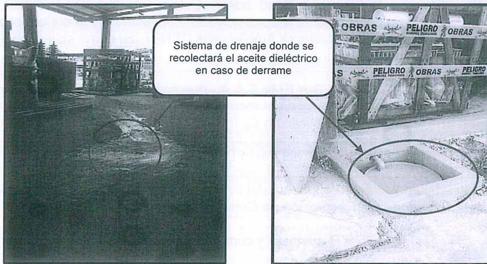
Vista Fotográfica N° 19 y 20: Se advierte la construcción final del sistema de drenaje y losa con pintura epóxica.
