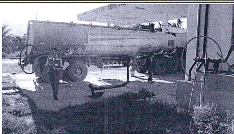
Fotografía N° 02. Vista de la zona de tanques, donde se evidencia que durante la descarga del CL, no se instaló la manguera para la conducción de vapores del camión cisterna hacia las válvulas del sistema de recuperación de vapores del establecimiento comercial.
