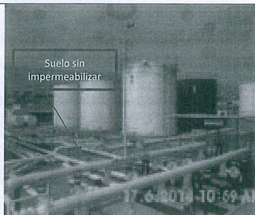
Registro Fotográfico N° 10. En la imagen se observa, el tanque 2 (G95), 4 (DB5 fuera de servicio) y 6 (D2 fuera de servicio), donde el área estanca de la base está conformada con suelo natural (sin impermeabilización) – Terminal Ilo.
