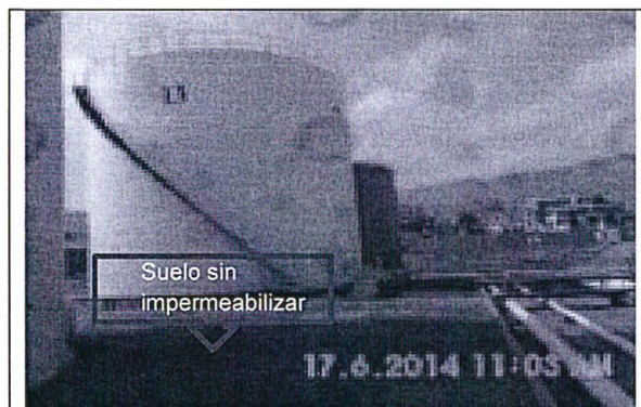
Registro Fotográfico N° 15. En la imagen se observa, el tanque 13 (D2), donde el área estanca de la base está conformada con suelo natural (sin impermeabilización) – terminal Ilo.
