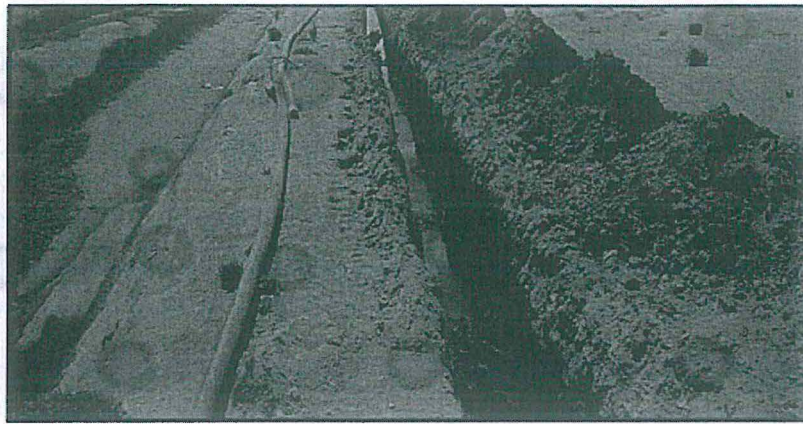
Foto N03: Excavación y retiro de tubería la cual derivaba aguas de afloramiento natural.
