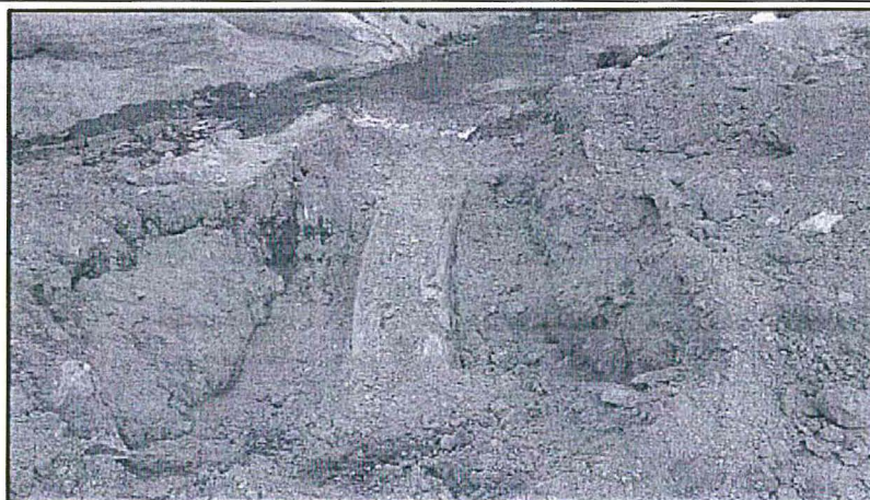
Foto N02: Se está realizando la excavación para el retiro de las tuberías de 4" para su posterior captación y derivación a la Planta de Tratamiento de Orcocochoa.
