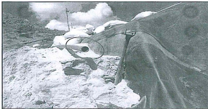
Fotografía N° 93. Hallazgo N° 3.- Vista de la tubería por la cual circulaba agua que se utilizaba para el riego por aspersión del depósito de relave, esta se encuentra seccionada.
