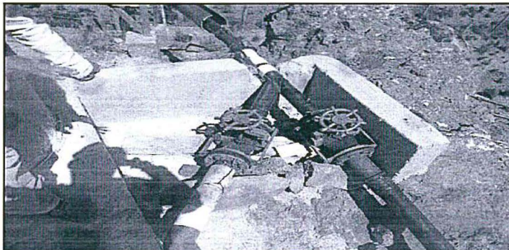
Fotografía N° 90. Hallazgo N° 3. La tubería se bifurca a través de una tubería "Y" en dos tuberías con una válvula en cada una. Las dos tuberías antes mencionadas, llegan a los aspersores instalados en el perímetro del dique de la relavera a través de reducciones a tuberías de dos pulgadas.
