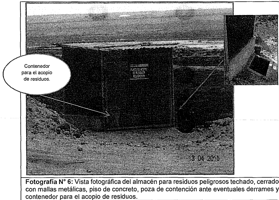
Fotografía N° 6: Vista fotográfica del almacén para residuos peligrosos techado, cerrado con mallas metálicas, piso de concreto, poza de contención ante eventuales derrames y contenedor para el acopio de residuos.
