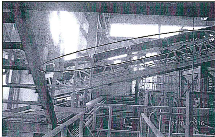
Fotografía N° 47. Hallazgo N° 01: Vista del mineral oxidado que se transporta mediante la faja N° 2, la cual está descubierta y descarga el mineral hacia la zaranda N° 2, que alimenta con mineral a la chancadora secundaria cónica de 300 HP.
