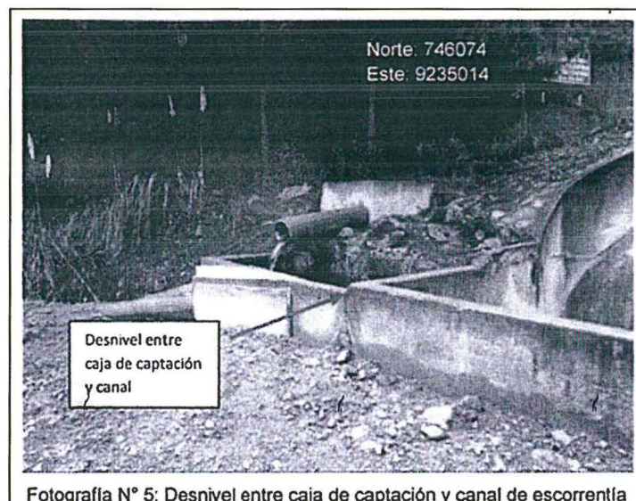
Fotografía N° 5: Desnivel entre caja de captación y canal de escorrentía
